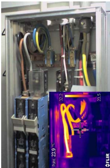
Maintenance préventive dans une armoire électrique
