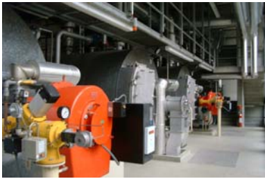
Chaudière du chauffage à distance de la Maladière, Neuchâtel
