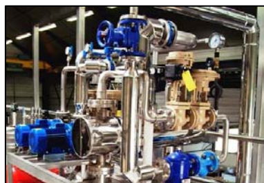
Installation de traitement d'eau
