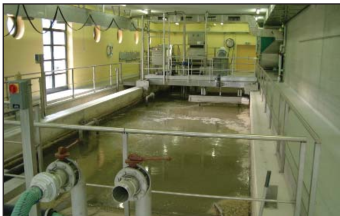
Récupération des sables et des graisses.
