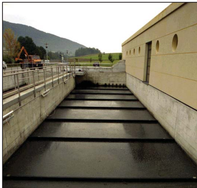
Bassin de décantation primaire.
